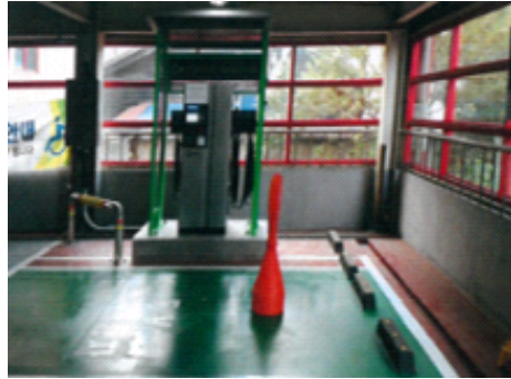
<충전시설 설치후 전경(실내)>
