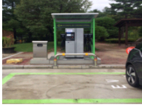
<충전시설 설치후 전경(실외)>
